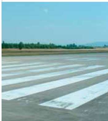
Le seuil de piste est matérialisé sur la piste par une ligne de traits de couleur blanche (peigne), à partir duquel un aéronef peut envisager une manœuvre de décollage ou d'atterrissage. Le seuil décalé à l'atterrissage est également balisé.
